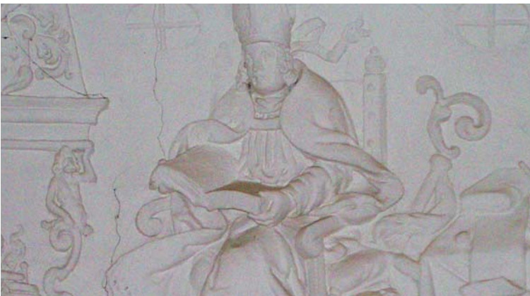
6 - DETAIL VAN HET MEDAILLON VAN AMBROSIUS. HET STUCRELIËF WORDT GEKARACTERISEERD DOOR EEN UITERST FIJNE TOETS. DEZE IS ZELFS NOG HERKENBAAR ONDANKS DE VELE LAGEN VERF DIE IN DE LOOP DER JAREN IS AANGEBRACHT.
