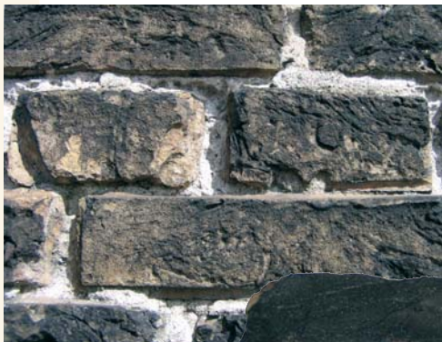
1 LINKS: VERVUILDE ZICHTZIJDE METSELWERK MOLEN AEOLUS TE VLAARDINGEN. ONDER: LEGVLAK (ZOOL) EN DE BUITENZIJDE (ZICHT) VAN EEN STEEN VAN MOLEN DE HOOP TE ROZENBURG.
